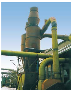
Рис. 1. Устаревшая циклонная установка, установленная на мебельном комбинате
