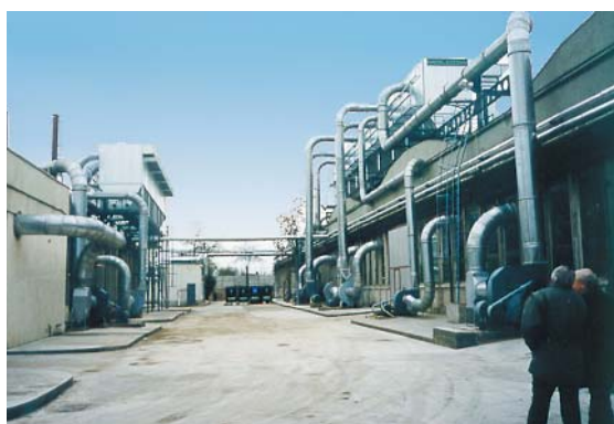
Рис. 2. Установленная взамен циклонов модульная фильтровальная система от JHM-Moldow
